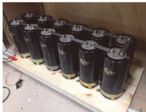
図9 全波整流派のリップル除去用コンデンサーバンク
